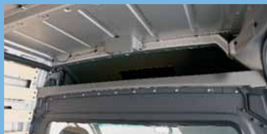
Bovenhoofds De ruimte boven de cabine is bereikbaar vanuit de laadruimte. Links de wat gammele plastic kabelgoot.
